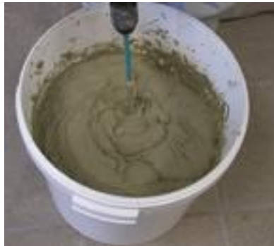
Der Mörtel wird mit einem Rührwerk angemischt. Komp. A + B in einen 30 l Kübel geben und 2 min. gut durchmischen- fertig.
